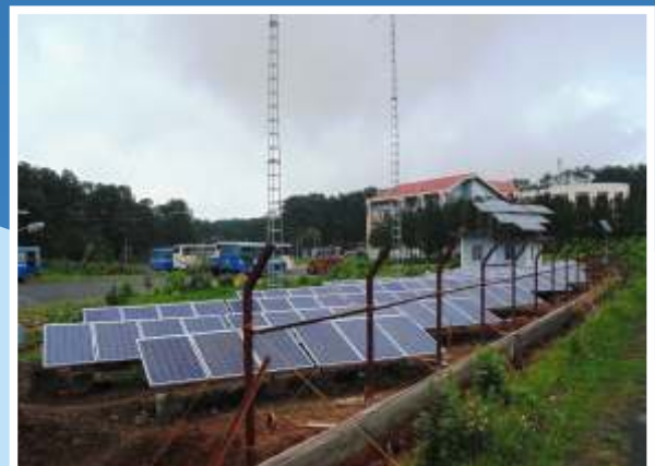
Capacity : 25 KWp Year : 2013
