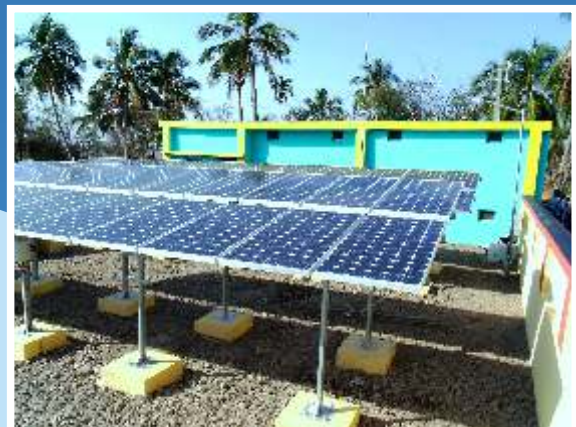
Capacity : 10 KWp Year : 2011
