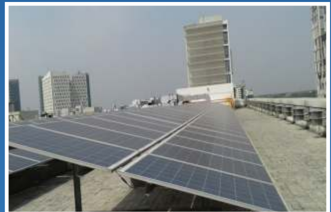
Capacity : 284 KWp Year : 2017
